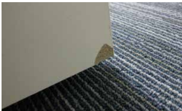
Obr. 5a - Poškozený roh mobilní stěny
