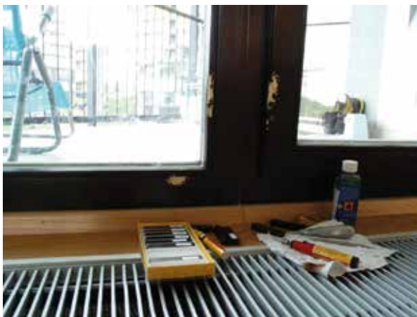
Obr. 2a - Poškozené dřevěné Eurookno od domácího mazlíčka
