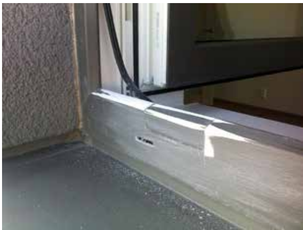
Obr. 1a - Poškozená fólie na platovém okně
