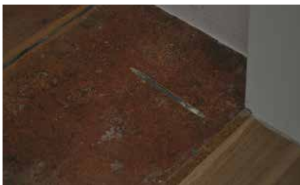
Obr. 4a - Keramická dlažba poškozená řezným kotoučem
